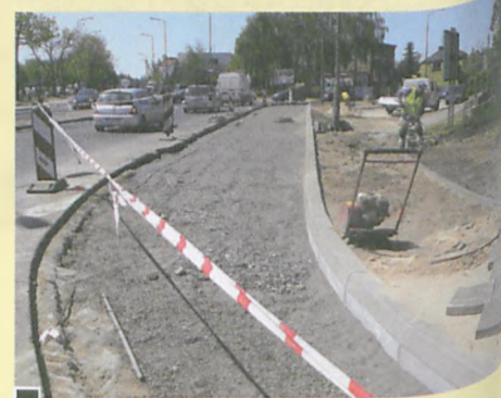
Po przeniesieniu podziemnych instalacji Netto wykonało dodatkowy pas ruchu fot. Paweł Wolniewicz
